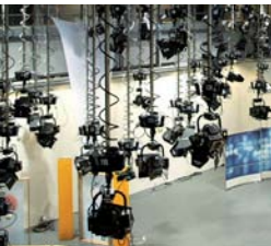
HR Studio mit Teleskopleuchtenhängern und motorischen Scheinwerfern
